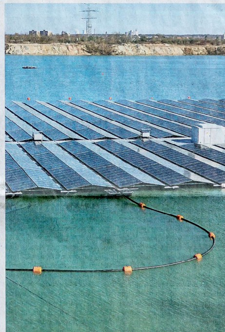
Ein dickes Kabel verbindet die Solaranlage mit der Trafostation am Ufer.
