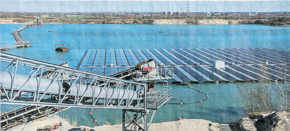
Energie fürs Sand- und Kieswerk liefert die schwimmende Photovoltaikanlage auf dem Baggersee. Sie ist einen Hektar groß und verspricht eine Leistung von bis zu 2,1 Megawatt.
